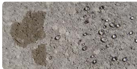
Lado Izq. sin proteger Derecho protegido con Nanoprotec®
